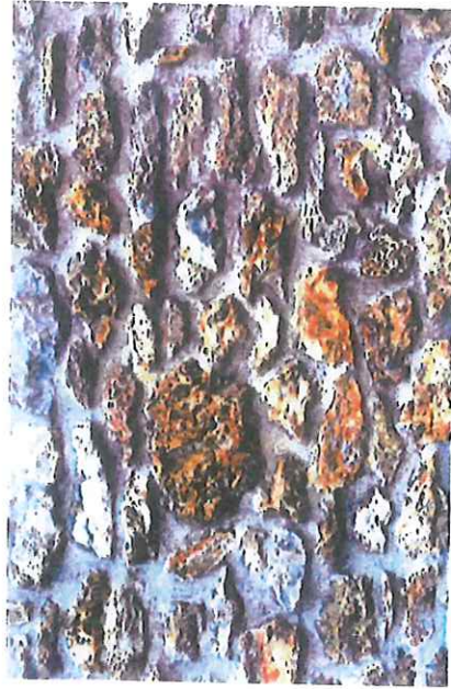
mise à nu abusive des moellons
